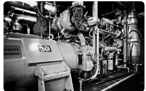
■ Nachhaltig und umweltschonend: Das Blockheizkraftwerk im Hallenbad erzeugt Wärme und Strom
